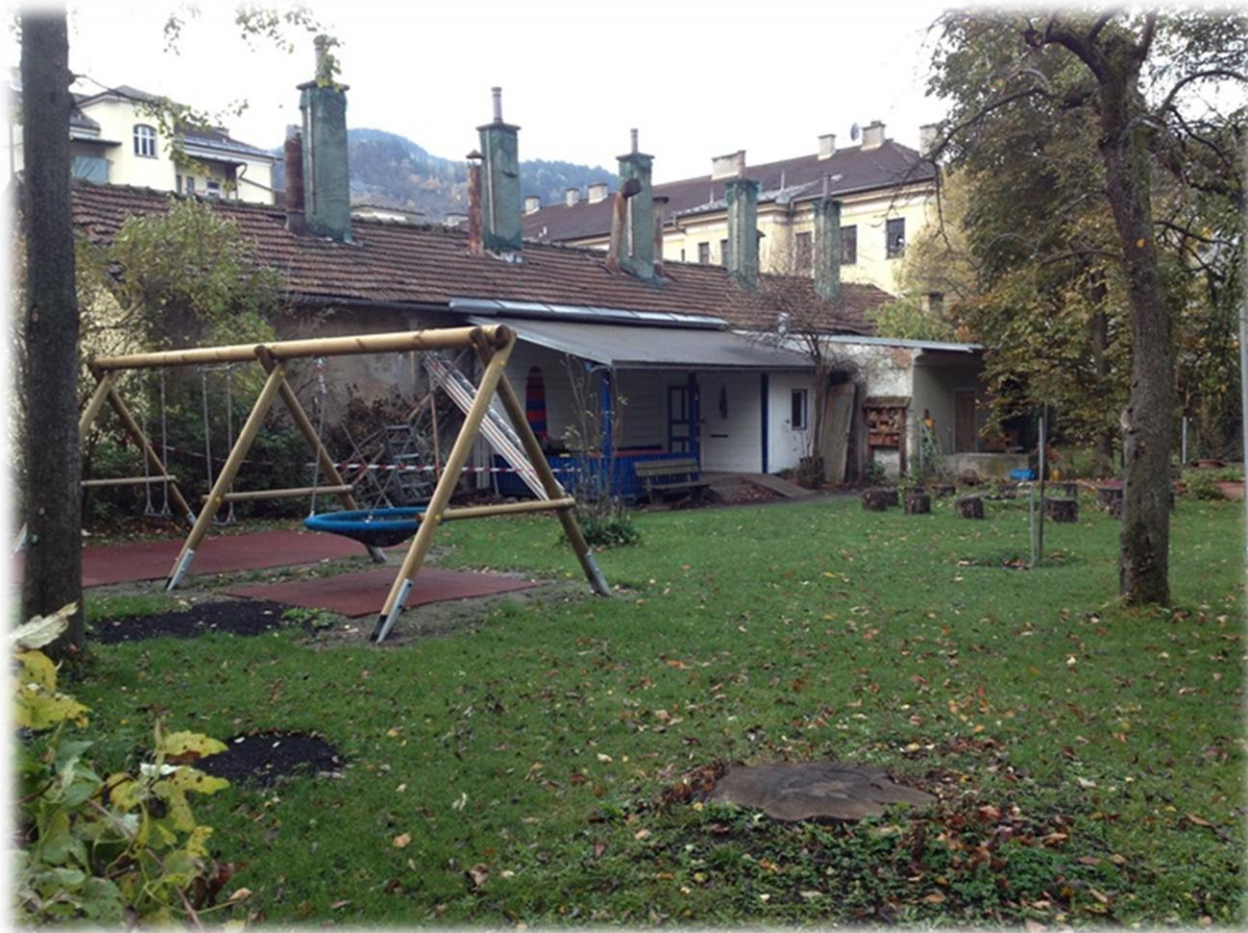
Der Garten des Kindergartens mit dem baufälligen Altbestand.
